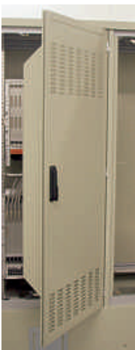
⇐ Kühl-System in der Türe eingebaut
